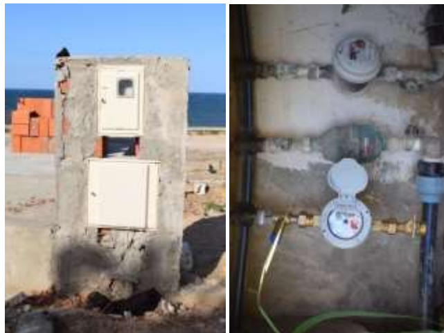
FIGURE 20: PHOTOS DES COMPTEURS STEG ET SONEDE INSTALLEES
