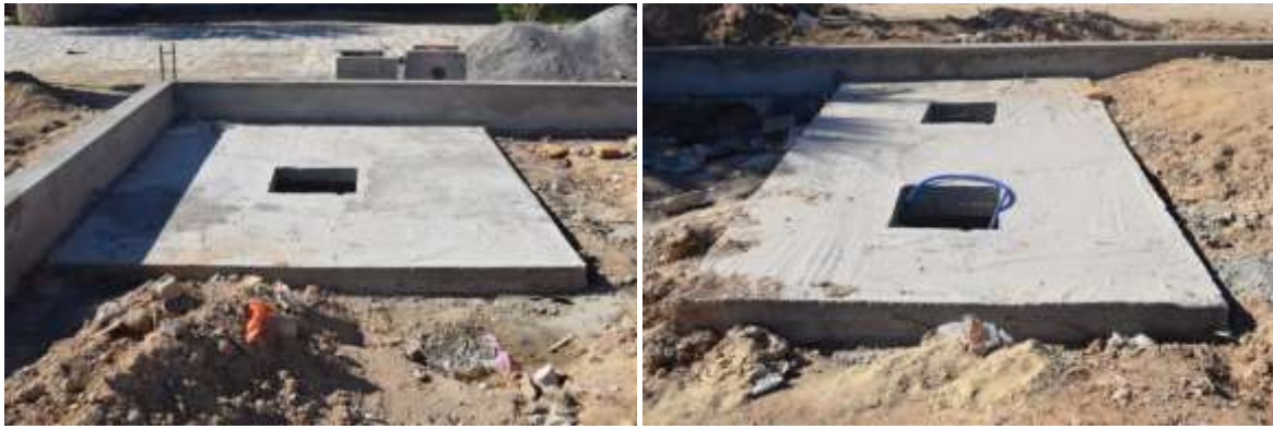
FIGURE 7: Photos (1 : fosse pour collecte d'eau pluviale, 2 : fosse pour collecte des eaux usées)
