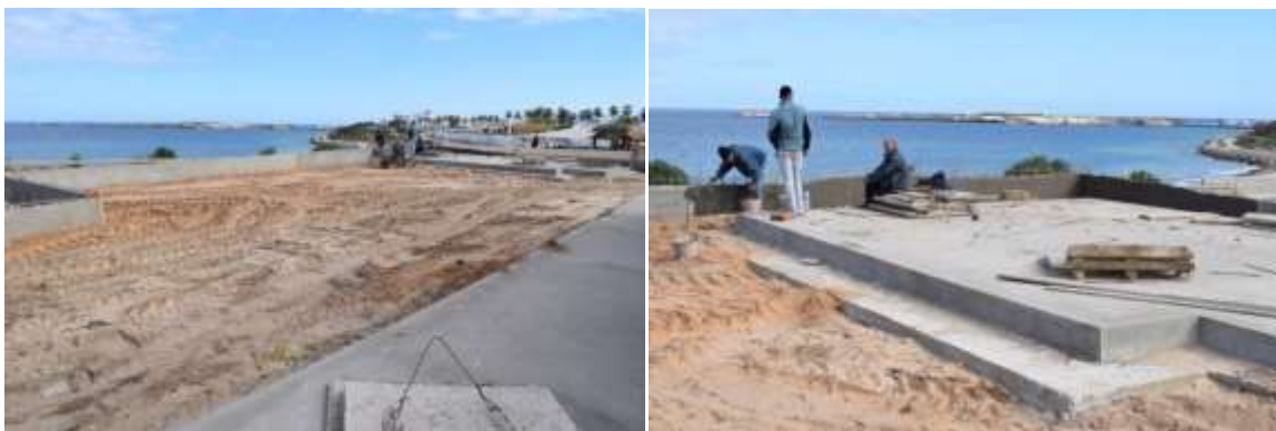
FIGURE 11: Avancement des travaux du voilier de la clôture (photos prises le 13 janvier 2021)
