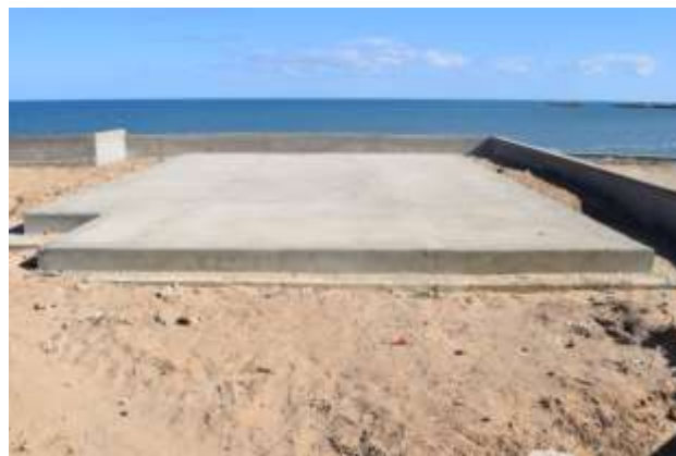
FIGURE 10: Photo de la plateforme destinée à recevoir les blocs en bois (Photo prise le 16 février 2021)
